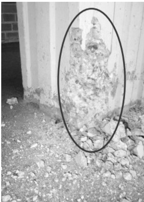
Pelare 1, hus 14-18, frysskador
