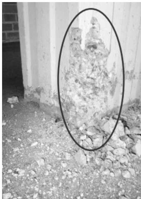
Pelare 1, hus 14-18, frysskador
